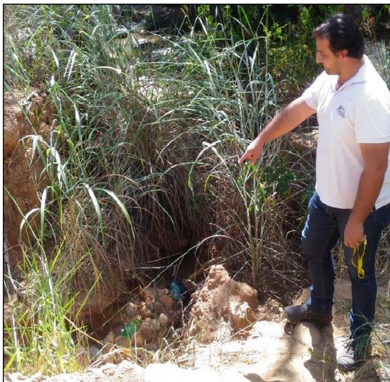
Figura 16. Identificação de erosão próxima ao Rio. Fonte: LOCALMAQ, 2017.
